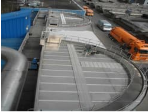
Klärwerk Wiesbaden: Alu- Abdeckungen für Nacheindicker.
