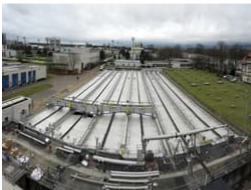
ARA Frankfurt/M.-Niederrad: isolierte Edelstahl (V4A) - Abdeckung für Vorklärbecken, ca. 2.500 m 2 .
